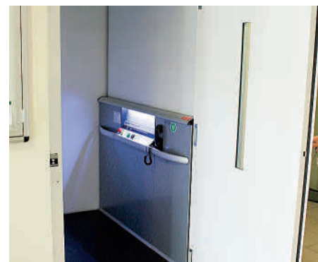
Winda w Centrum Rehabilitacji i Sportu UJK ma panel multimedialny i telefon.
